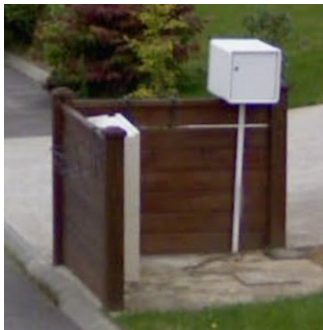
Intégration des coffrets techniques dans un habillage bois
