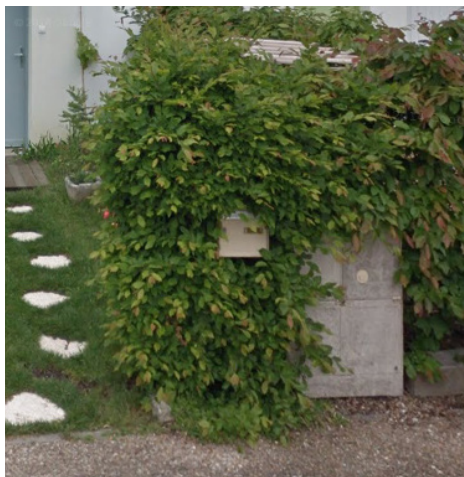
Intégration des coffrets techniques dans la haie
